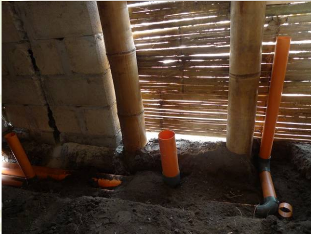
41. Tubos de drenaje
